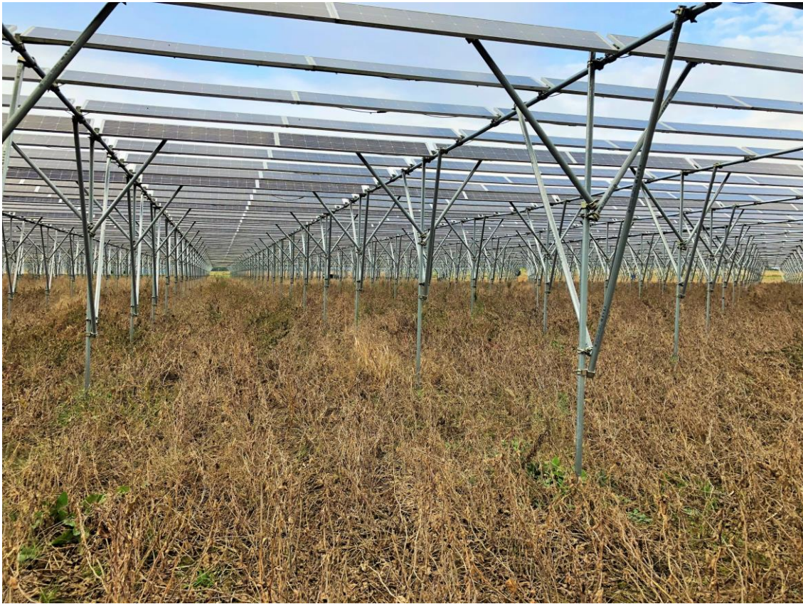
「 匝瑳メガソーラーシェアリング第一発電所 」の太陽光パネル下
